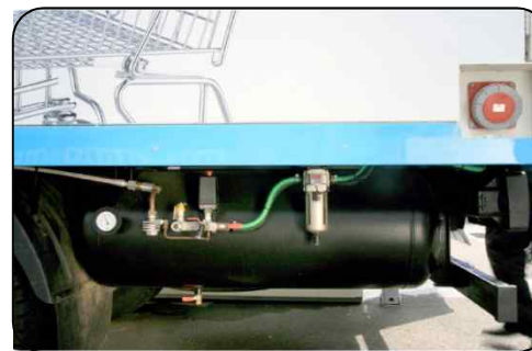
공기압축기 / Air compressor
